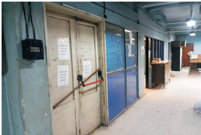
Salida de emergencia obstruida.
