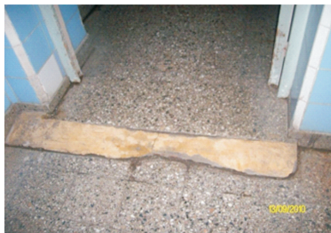
Posibilidad de resbalones y/o caídas al mismo nivel por superficie o terreno resbaladizo, desparejo.
